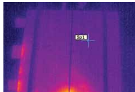
Questa immagine termografica mostra dei difetti nell'isolamento perimetrale della cella, che causano shunt locali.
